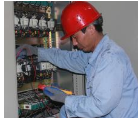
王刚在检查配电柜电压
