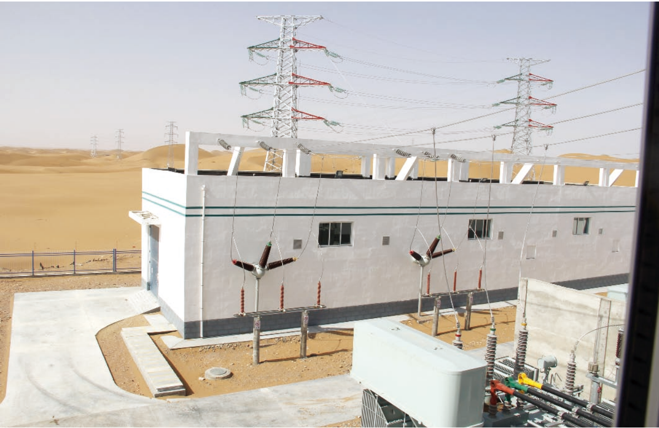
■110kV变电站工程概貌
